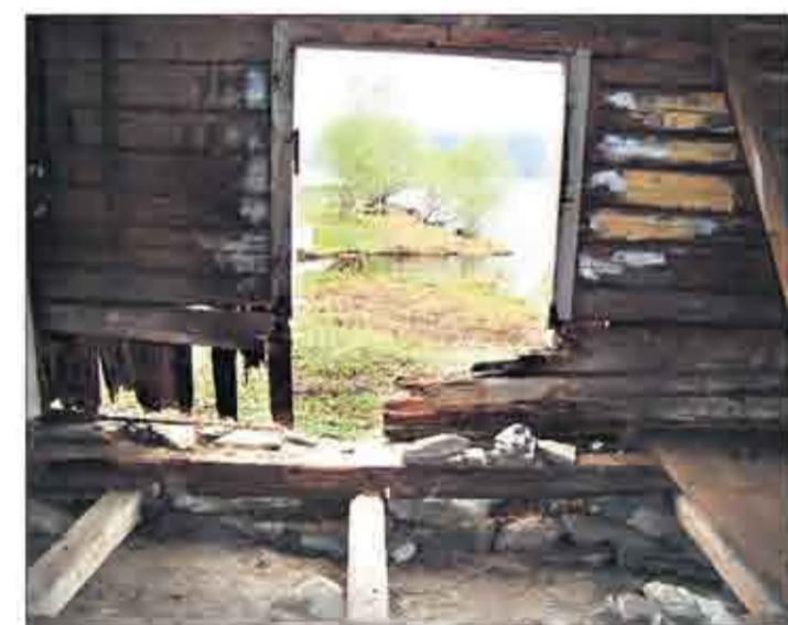
RÅTE: Det var ikke bare styllstokkene som var råtne da Anne-Britt Eggen kjøpte Garveriet. Dette bildet ble tatt i mai 2011. Foto: Privat
