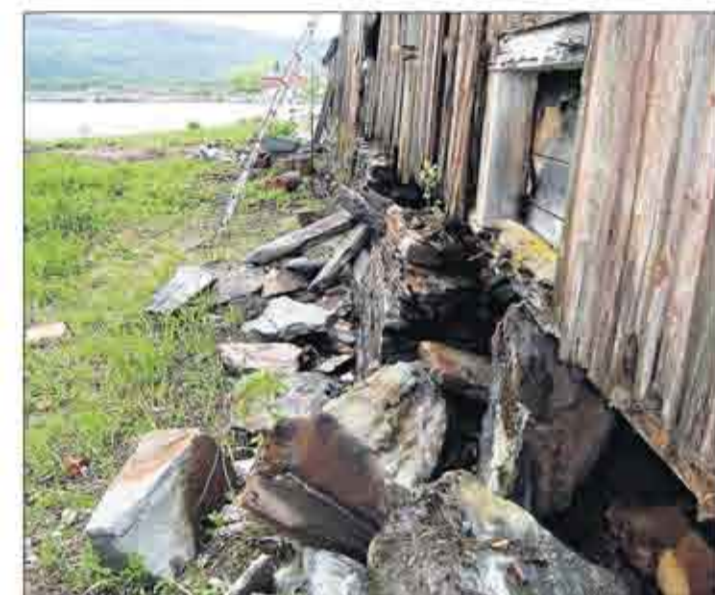
GRUNNMUR: Grunnmuren hadde gitt etter under store deler av bygget. Dette bildet er tatt på nedsiden mot Snåsavatnet i mai 2011. Foto: Privat
